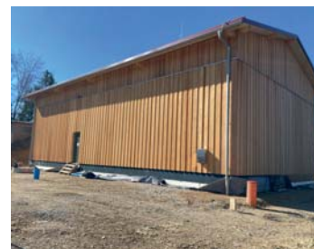
Der neue Hochbehälter.
